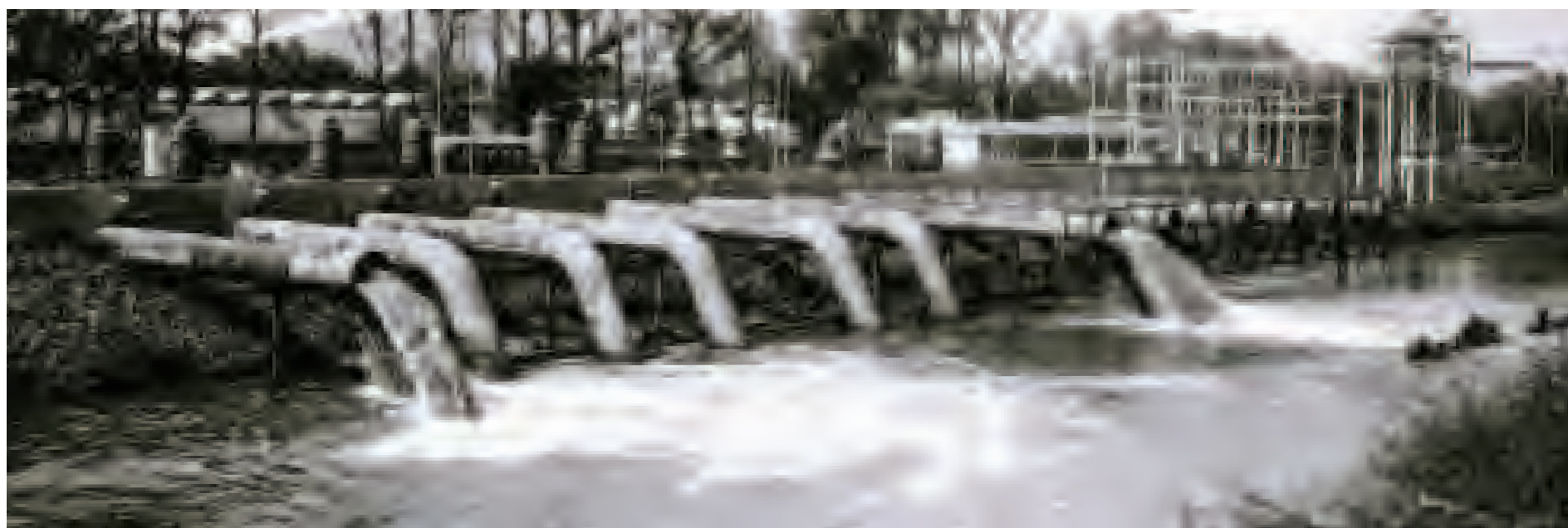
Planta de bombeo 7 situada en el km 6.5 del Gran Canal (San Juan de Aragón), Distrito Federal, 1976 (ABAJO). Autor: Oficina de fotografía Víctor Barrera. Medidas: 12 x 16 centímetros. Colección Fotográfica, caja 318, expediente 9074, Núm. Inv. CF-09-9074. Fuente: Archivo Histórico del Agua.
